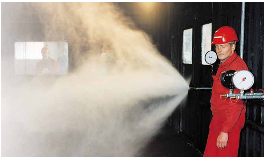
Funktionsprüfung von Brandschutzeinrichtungen.
